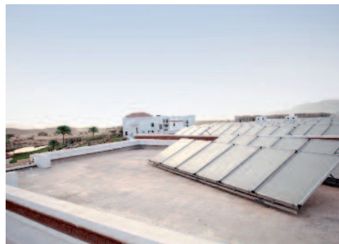
Solaranlage auf dem Robinson Club Agadir
